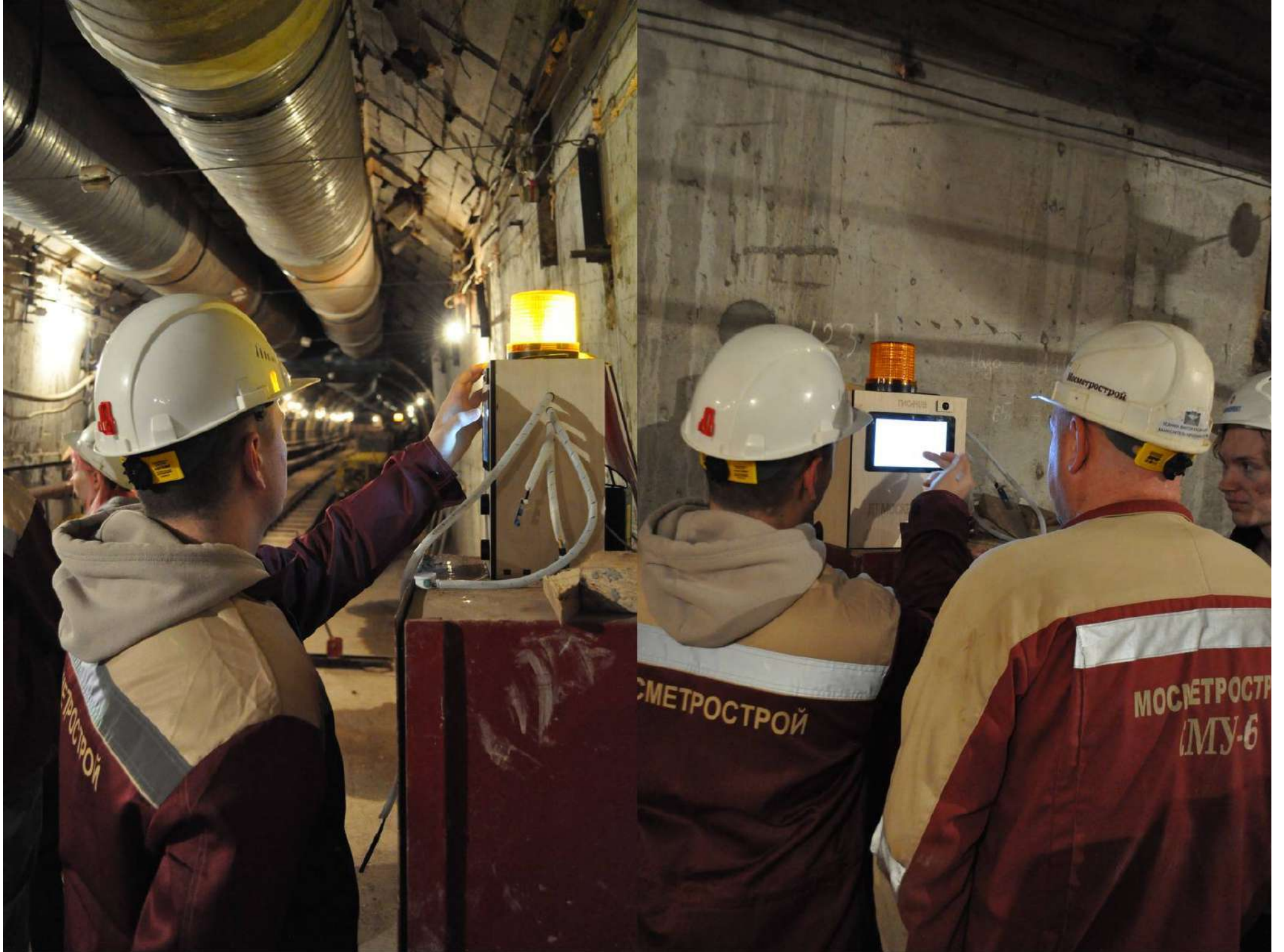
Пилотное тестирование системы диагностики в СМУ-6 АО "Мосметрострой"
